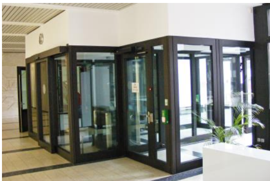
Eingang zu einem Gericht: Türschleuse mit Schiebetüren, separate Ein- und Ausgänge und Fluchtwegtüren.
