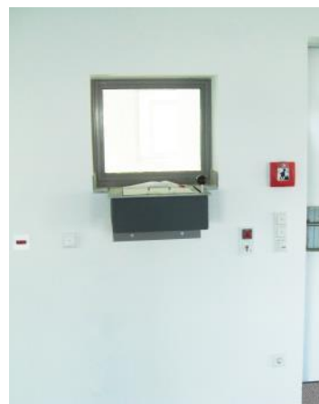
Schalterfenster und Schiebemelde: Kombierter Schutz gegen Durchschuss und Brandschutz (Sonderkonstruktion).
