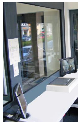
Eingangspforte eines Gerichtsgebüdes: die Pförtnerkabine ist ausgestattet mit Schalterfenster incl. Schiebemulde, Sprechanlage, Tür- und Schleusensteuerung, Videoüberwachung.
